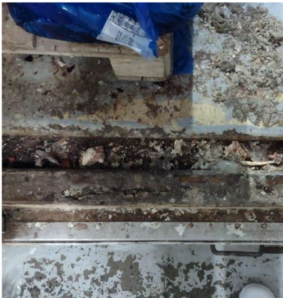
Figura 30 - Piso da câmara de congelados – irregular e com acúmulo
